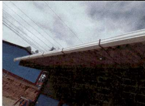
Foto 5: El canal de este modulo, estaba en malas condiciones, por lo que fue necesario reemplazarlos por nuevos.
