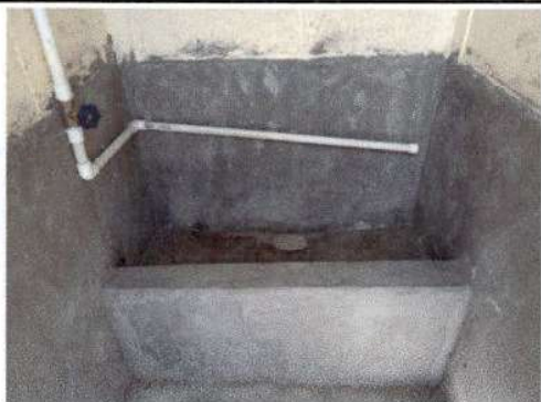
Foto 1: Este modulo de baños no contaba con mingitorio, por lo que una tasa se eliminó y se construyó un mingitorio de concreto.
